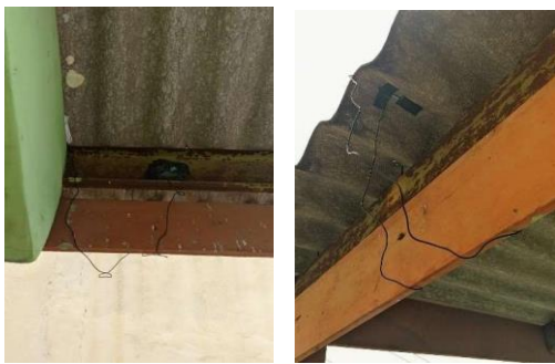
Gambar 4. Elitech Rc-4 Temperature Data Logger yang dipasang pada permukaan atap balai rw (atas dan bawah)
