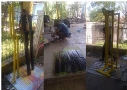
Gambar 7. Pembuatan Komponen Berdasarkan Modul-Modul untuk Memudahkan Pindahan dan Instalasi di Tempat Wisata
