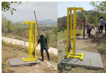
Gambar 8. Instalasi alat di daerah wisata Gunung Pegat Desa Karangasem.
