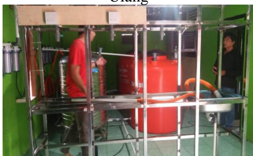
Gambar 9. Kondisi Terpasang Tempat Pengisian Air Siap Minum
